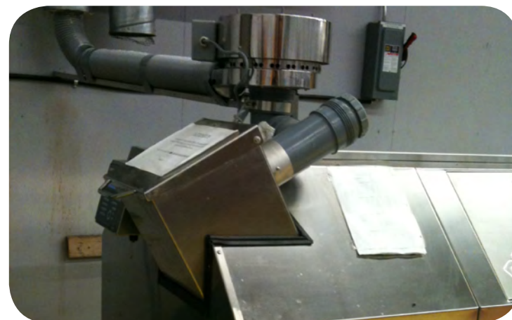
Capture de l'air vicié dans le composteur Crédit : SAQ
